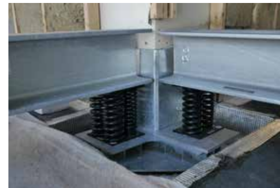
Ressorts mis en place sous la plateforme métallique des TAR pour éviter la transmission des vibrations au data center.
