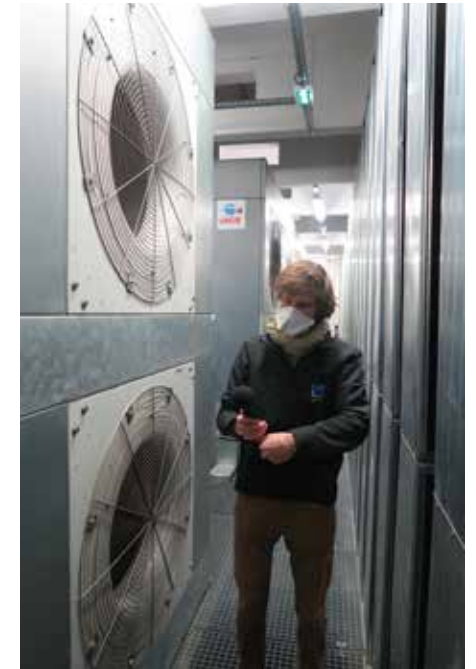
Mesure du bruit émis par les installations de tours aéroréfrigérantes (TAR)
